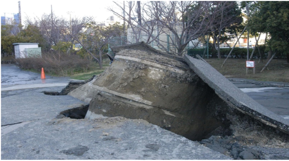
液状化現象による飛び出したマンホール
