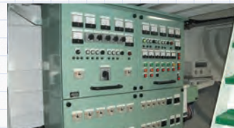
▲弊社で製作している配電盤
