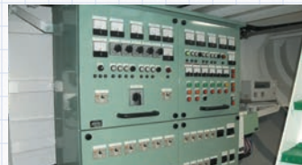
▲弊社で製作している配電盤
