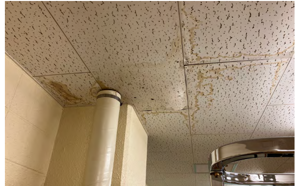
写真 2-26 トレーニング室の雨漏り
