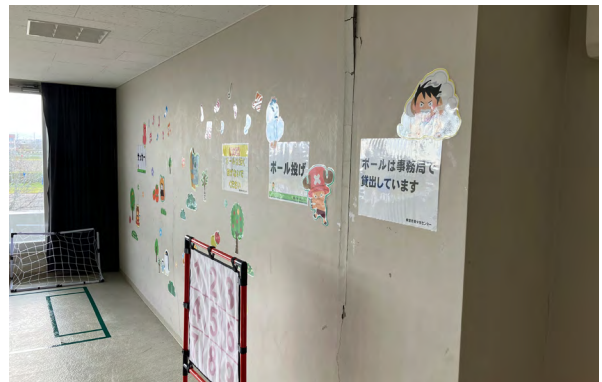
写真 2-6 躯体のひび割れ
