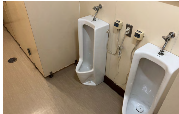
写真 2-20 手すりの無いトイレ室内
