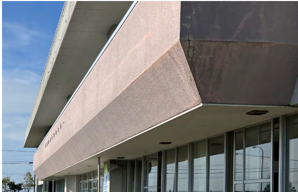
写真 2-3 外壁の劣化状況
