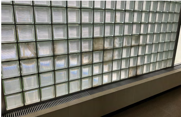
写真 2-25 ガラスブロックの破損
