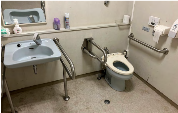
写真 2-9 オストメイト未対応の多目的トイレ
