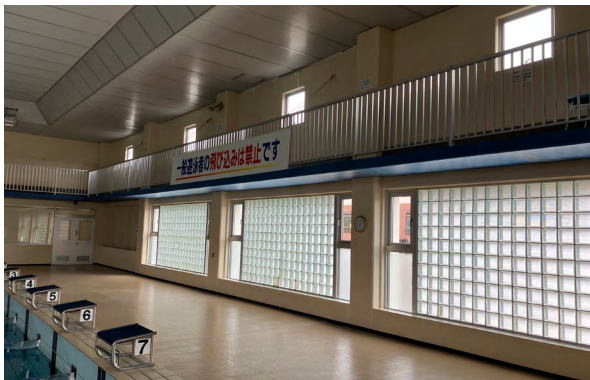
写真 2-27 断熱性能の低い窓
