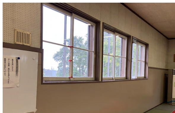
写真 2-16 劣化により歪んだ窓枠
