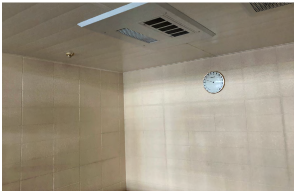
写真 2-33 不調の見られる設備機器
