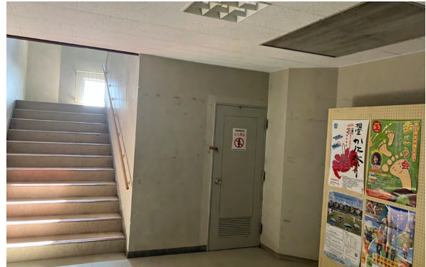
写真 2-10 エレベータの未設置（階段のみ）
