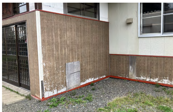
写真 2-15 補修跡が目立つ外壁
