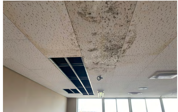
写真 2-4 雨漏りによる天井の劣化状況
